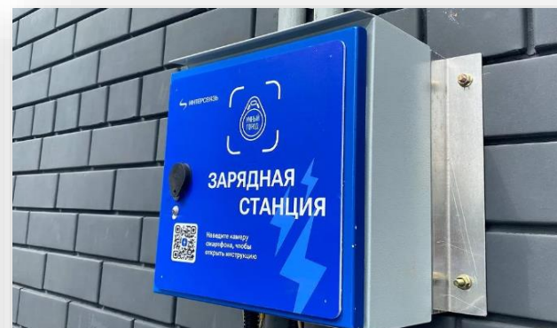
Электрозаправочная станция по адресу: ул. Телевизионная, 12
